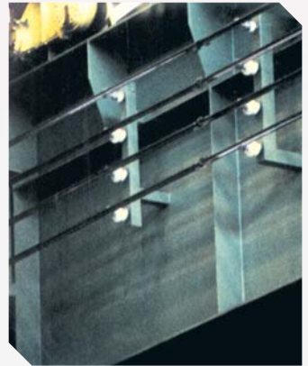
Instalación de carriles con pie de acero y cabeza de cobre en siderurgia, tensión de alimentación 6 KV.
